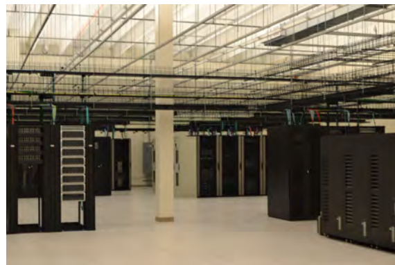
NDUS Data Center
